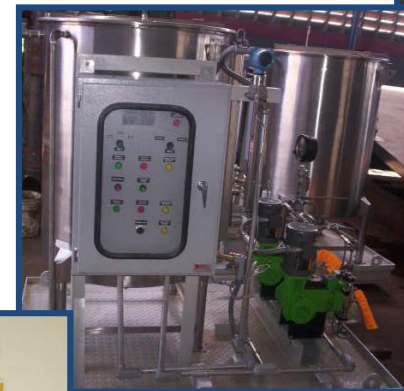
PAQUETE INSTALADO EN PETROQUIRIQUIRE
