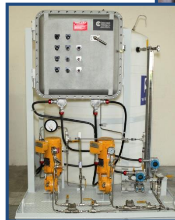
PAQUETE INSTALADO EN NIGERIA
